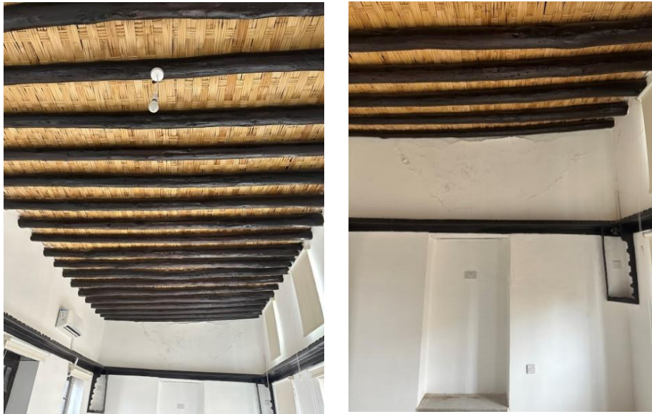
Şekil 58: Üst Kat Çatı Örtüsündeki Mertek Ve Hasır Kullanımı
