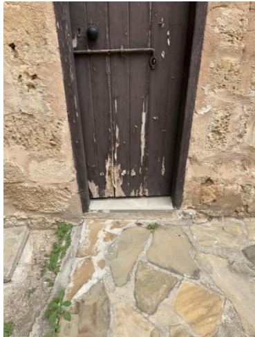
Şekil 175: Ahşap Kapılarda Boya Soyulması
