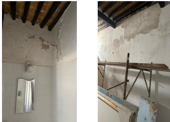
Şekil 170: Duvarlarda Sıva ve Boya Dökülmeleri
