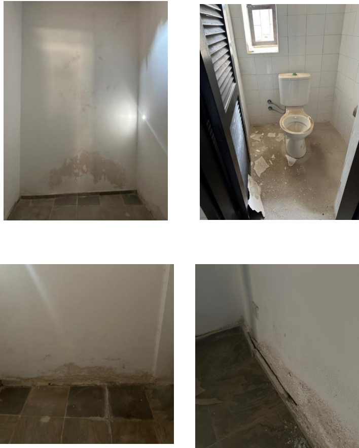
Şekil 171: Sıva Dökülmeleri ve Kırık Süpürgelikler
