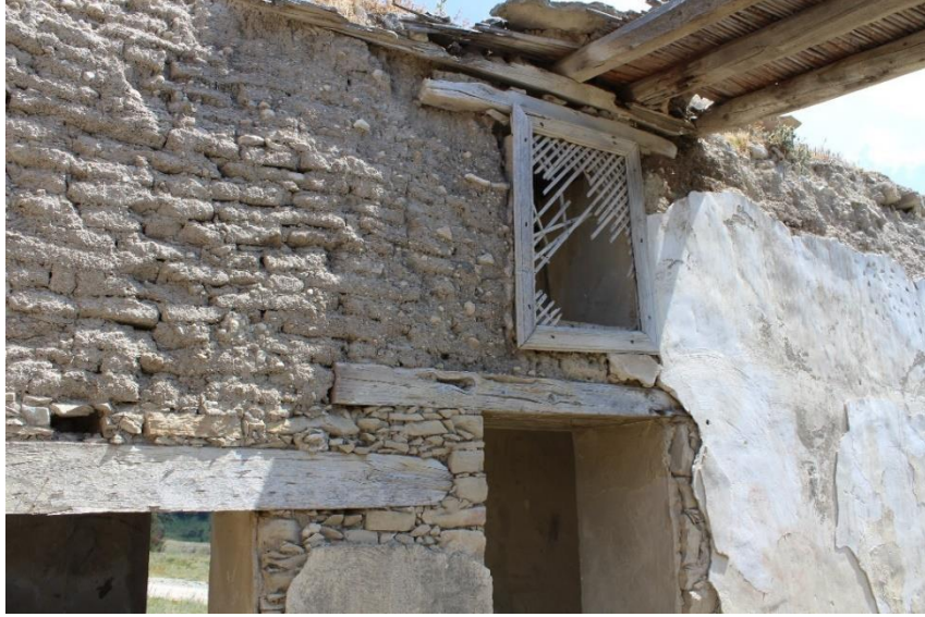
Şekil 74: Duvarı Yüzeyindeki Kerpiç'in deforme oluşu (Soykök, 2023)
