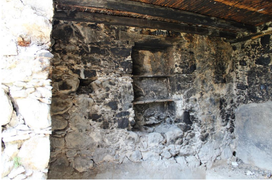
Şekil 73: Z7 Duvarı Yüzeyindeki Kararmalar (Soykök, 2023)
