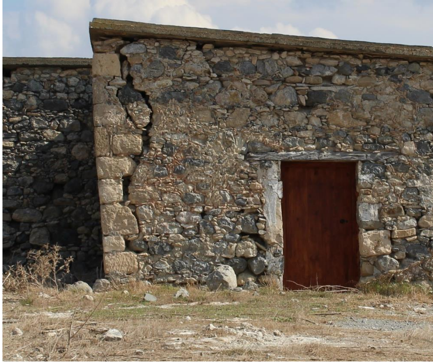
Şekil 72: Z8 Duvarı üzerindeki çatlak (Soykök, 2023)
