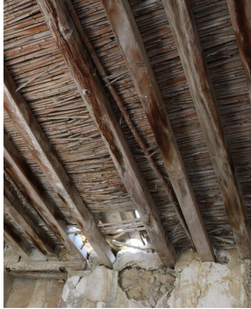
Şekil 77: Hasırda Oluşan Boşluklar (Soykök, 2023)
