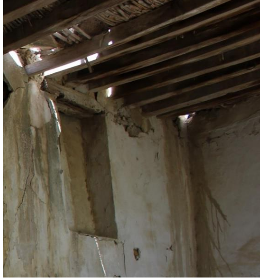
Şekil 78: Duvar üzerinde Küflenme (Soykök, 2023)
