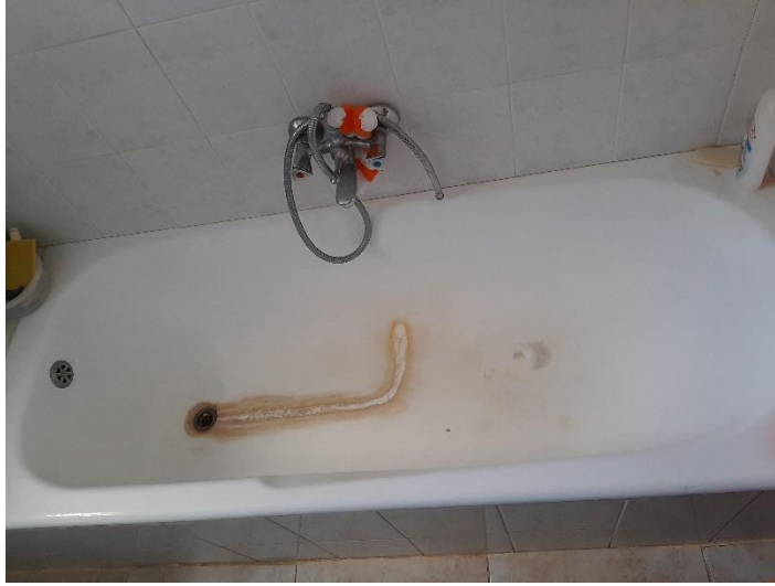
Şekil 6. Banyo zemininde kaymayı önleyici material bulunmaması
