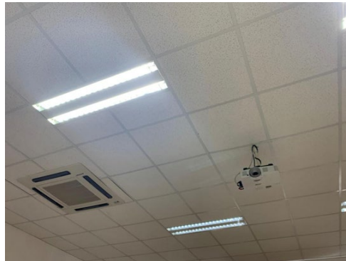
Şekil 4.14: Merkezi Derslik Binası İç Mekanları Tavan Malzemesi (Taş Yünü) Kullanımı
