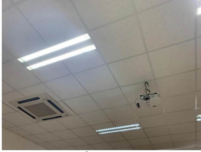
Şekil 4.20: Merkezi Derslik Binası İç Mekân Aydınlatma Elemanları Kullanımı
