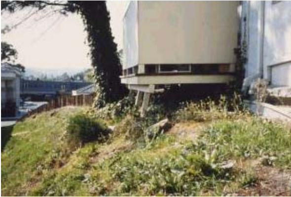
Şekil 7. Zemin gerilmesinden/şişmesinden kaynaklanan bina oturmasına bir örnek
