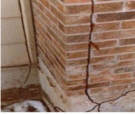
Şekil 5. Kolon üzerinde oluşan şişen bir zemin sorunu
