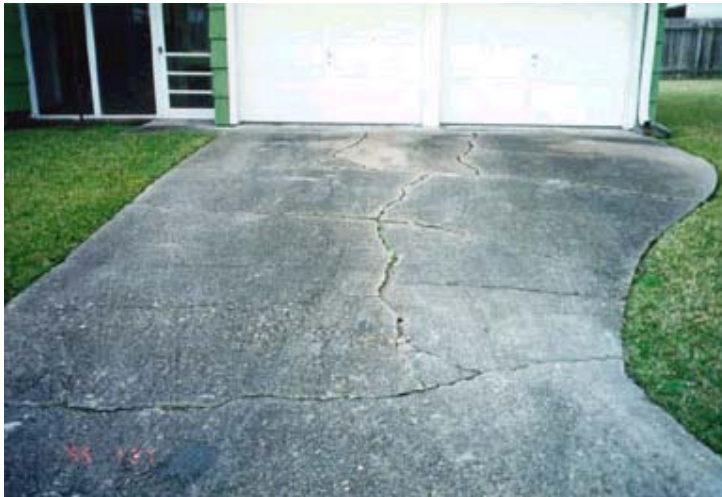
Şekil 4. Şişen bir zeminden kaynaklanan garaj yolu çatlakları
