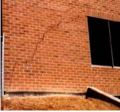
Şekil 6. Duvarda şişen zemin ve gerilmelerinden oluşan çatlaklar
